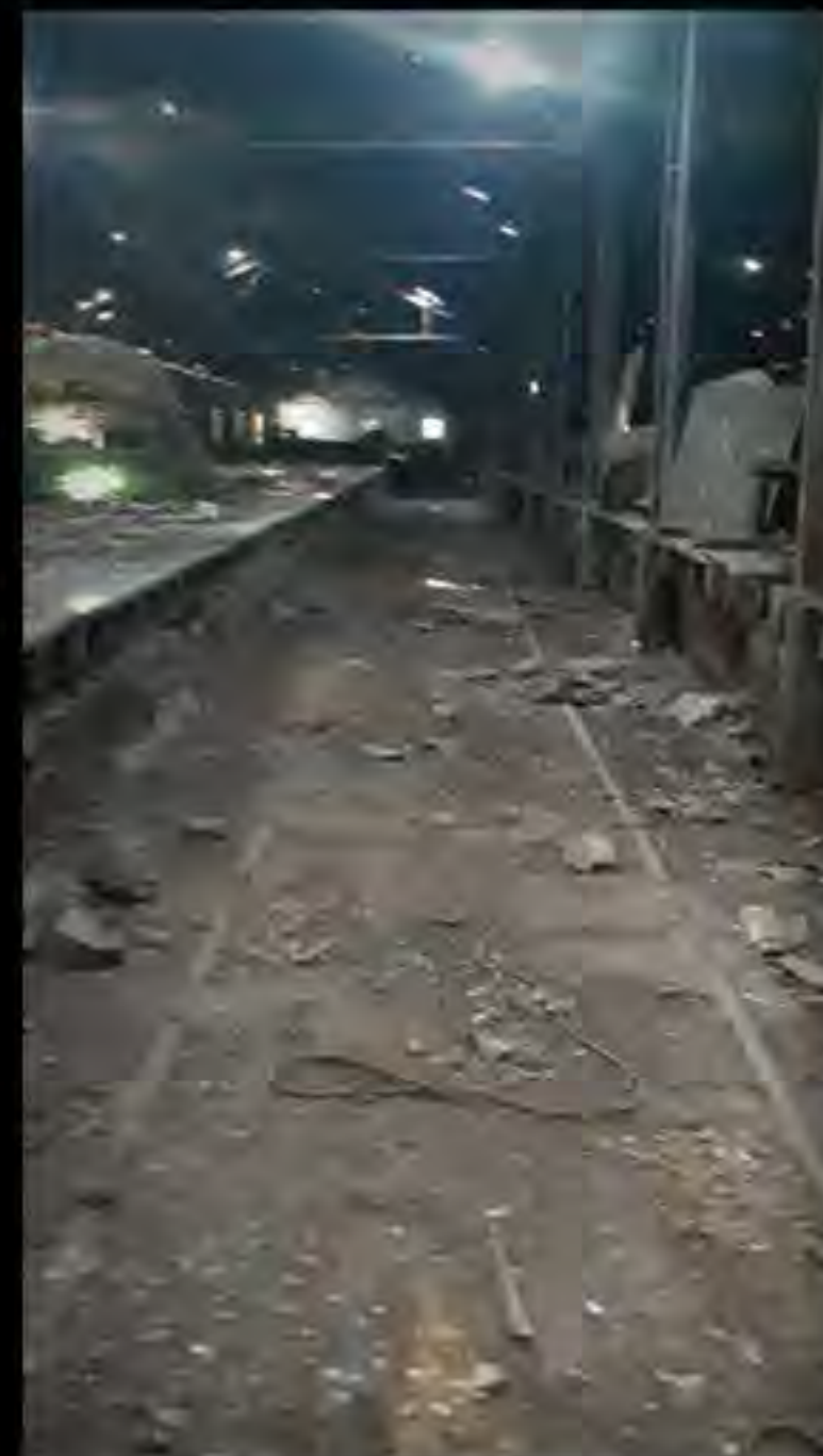
IMG. 43. TRILHOS EM RUÍNAS PRESENTES NO ARMAZÉM
